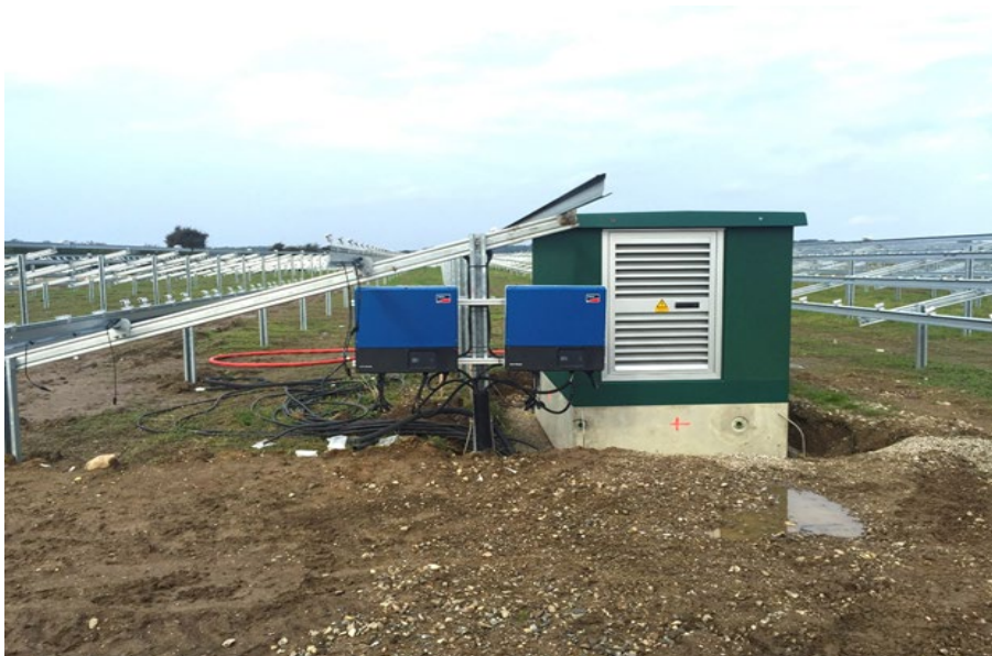
Invertere (blå) og step-up transformere i anlægget
